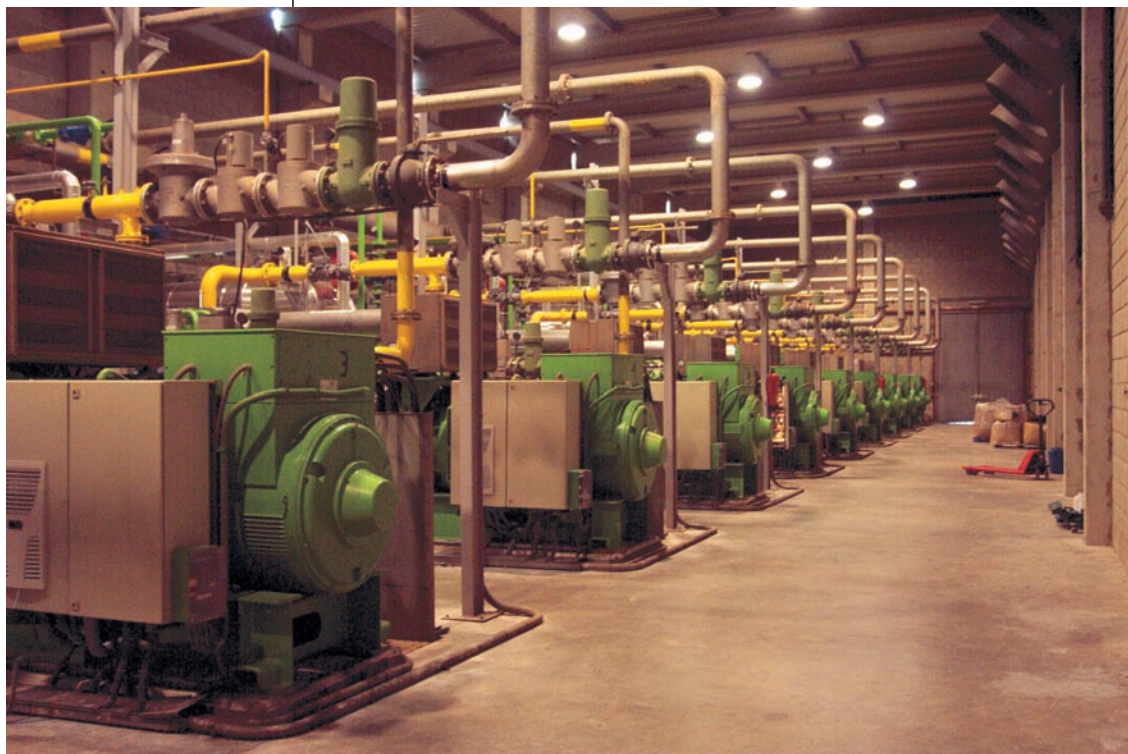
Foto 6.7. Sala de motores.
